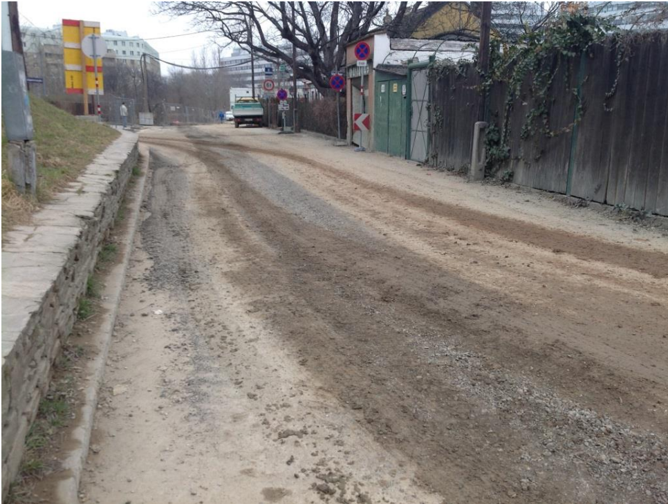
Abbildung 2: Verschmutzung der an die Baustellenausfahrt anschließenden öffentlichen Straße
