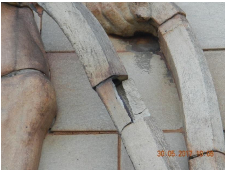
Abbildung 13: Beschädigung am Relief durch Witterungseinfluss
