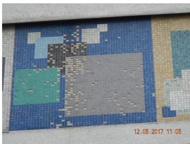
Abbildung 16: Fehlen von Mosaiksteinen
