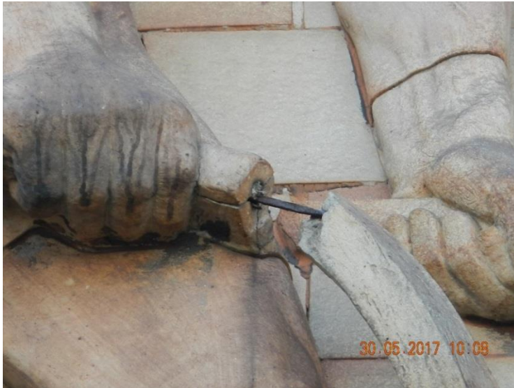
Abbildung 12: Beschädigung am Relief durch Witterungseinfluss
