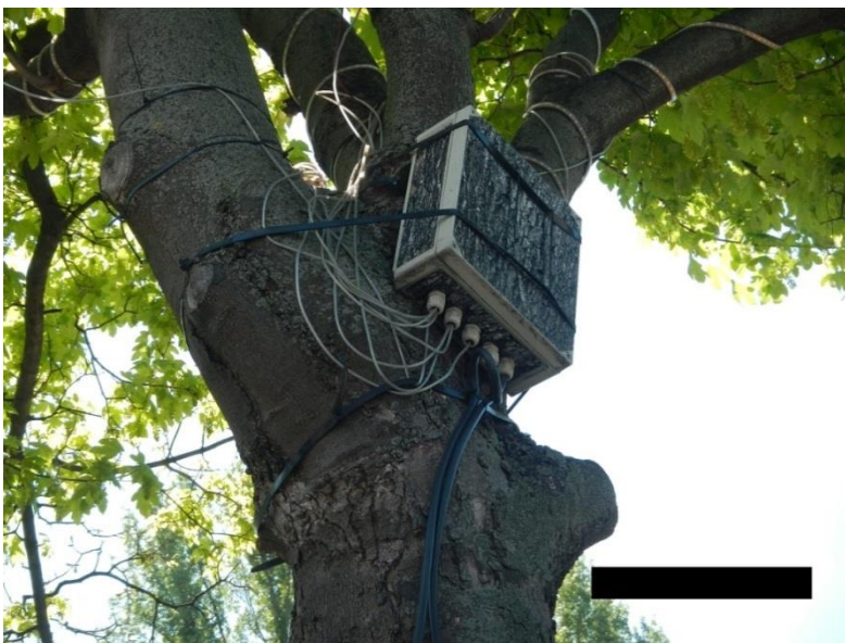
Abbildung 15: Nicht normgemäß ausgeführte Befestigungen
