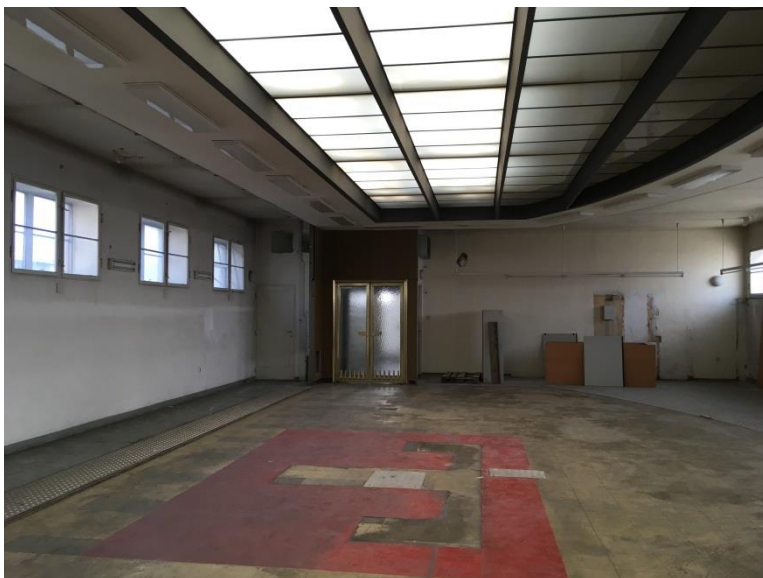
Abbildung 15: Umspannwerk Favoriten - Leerstehender Büroraum
