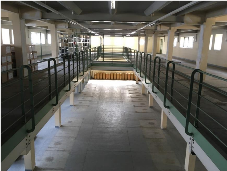
Abbildung 16: Umspannwerk Favoriten - Innenansicht 1
