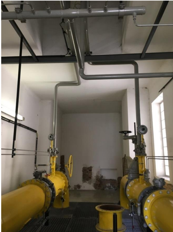
Abbildung 22: Gasdruckregelgebäude Währing - Innenansicht
