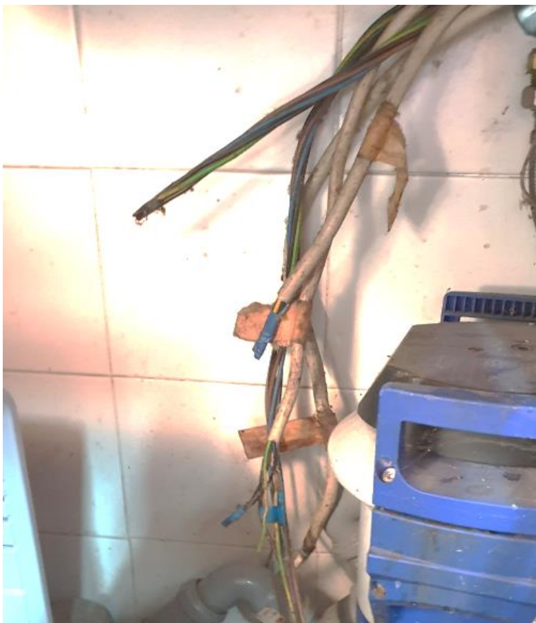
Abbildung 2: Lose herabhängende, jedoch isolierte Kabelenden
