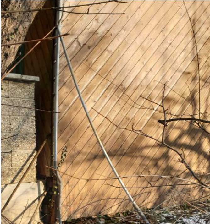
Abbildung 4: Nicht befestigtes Installationsrohr im Freien
