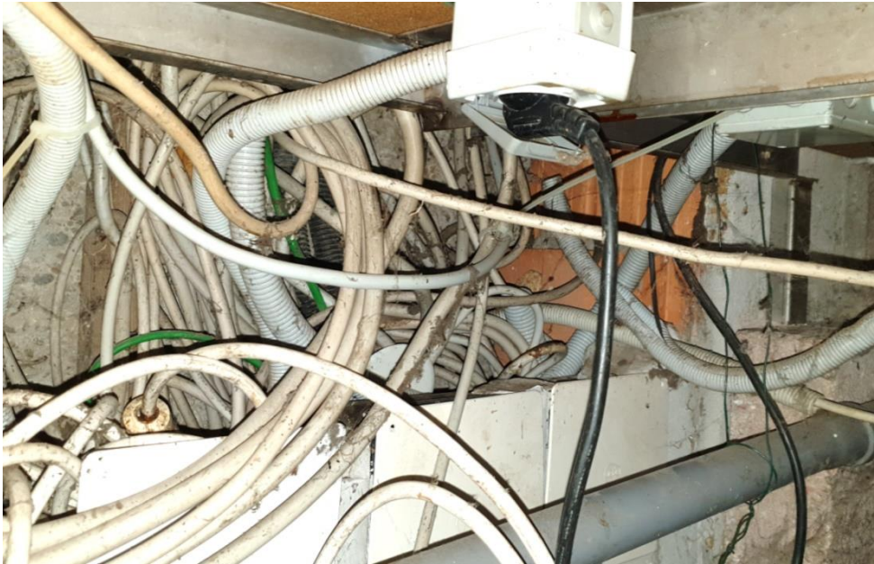
Abbildung 3: Unsachgemäße Verlegung der Kabel bei der Einführung in den Hauptverteiler
