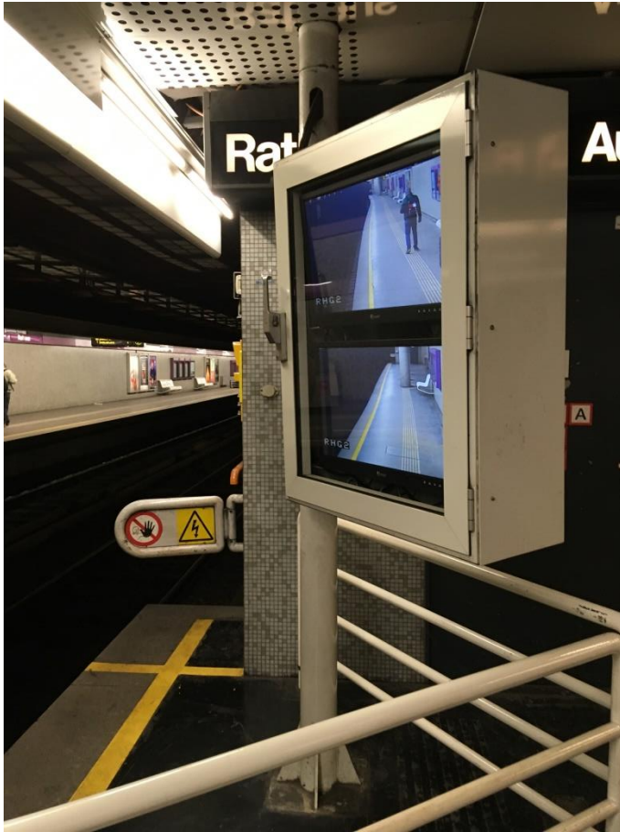
Abbildung 2: Bildschirme als Abfertigungshilfe in der Station Rathaus der U-Bahnlinie U2 in Fahrtrichtung Seestadt
