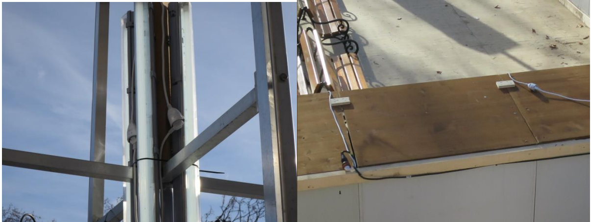
Abbildungen 7 und 8: Ungeeignete Schukosteckverbindungen
