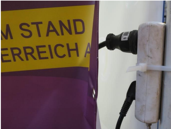
Abbildung 12: Nicht entsprechende Steckvorrichtung
