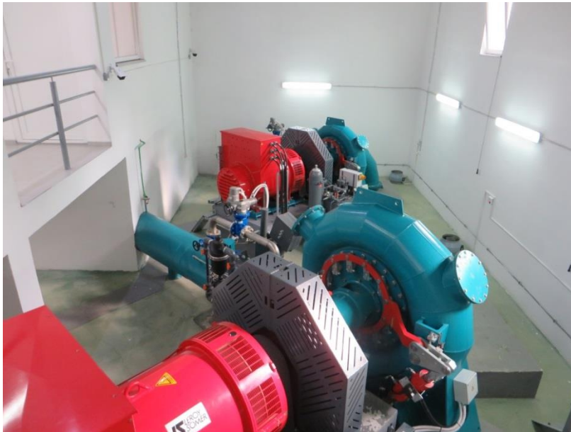
Abbildung 7: Kraftwerk Rujevica Ušće - Innenansicht
