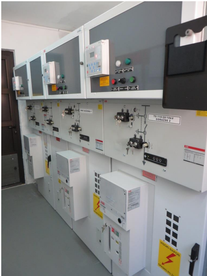
Abbildung 18: Kraftwerk Sućeska RS-2 - Innenansicht (Steuerungseinheit)
