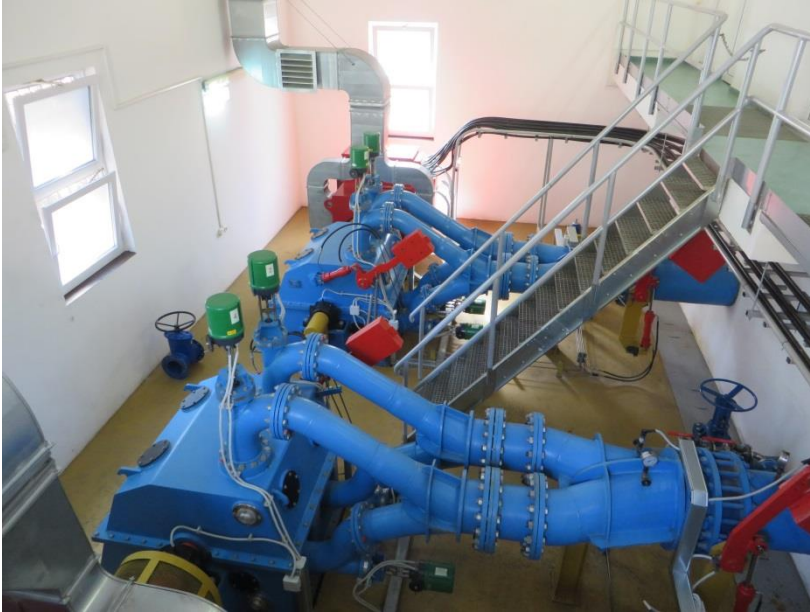
Abbildung 15: Kraftwerk Sućeska RS-1 - Innenansicht
