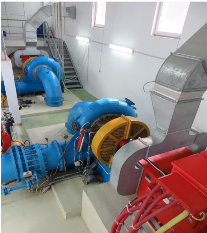
Abbildung 10: Kraftwerk Botašnica Ušće - Innenansicht
