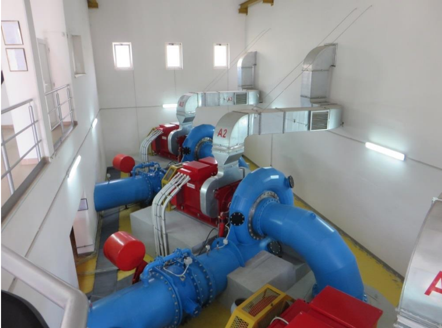
Abbildung 5: Kraftwerk Čardak - Innenansicht
