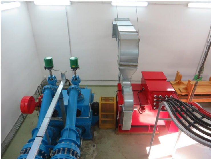
Abbildung 17: Kraftwerk Sućeska RS-2 - Innenansicht (Turbine)
