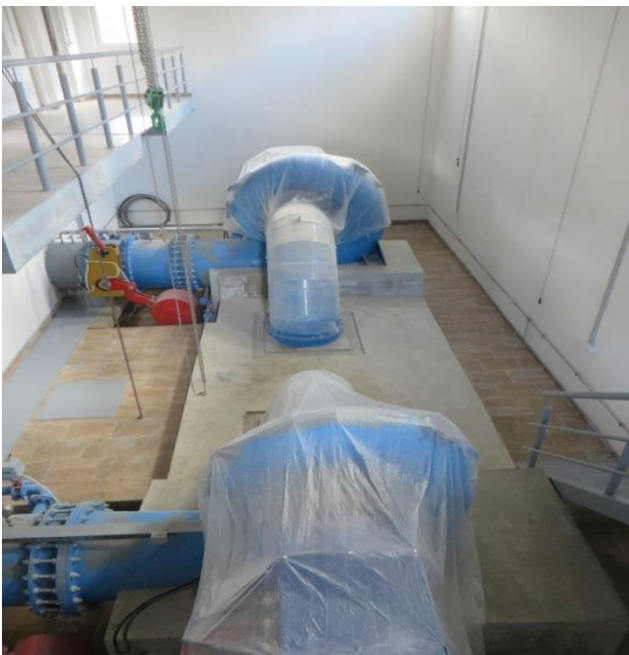
Abbildung 12: Kraftwerk Kamenica - Innenansicht
